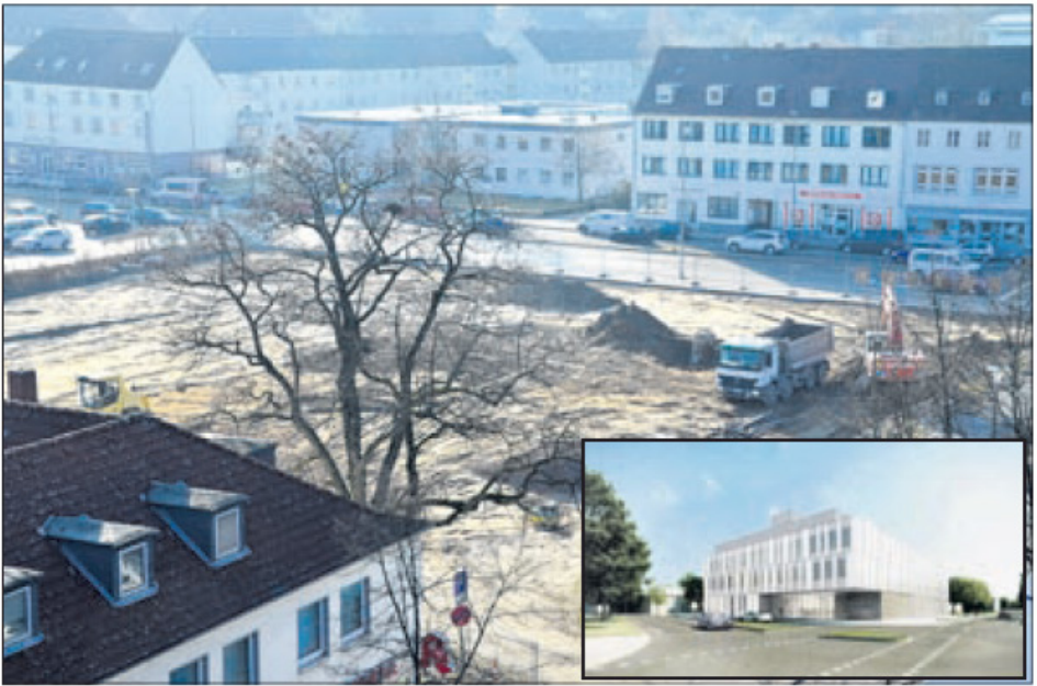
Aktuell wird die Fernwärmeleitung auf dem Areal des neuen Ostfalia-Laborbaus (Grafik: Nickl & Partner Architekten, Berlin) verlegt – im Januar 2017 ist der Einzug geplant.
