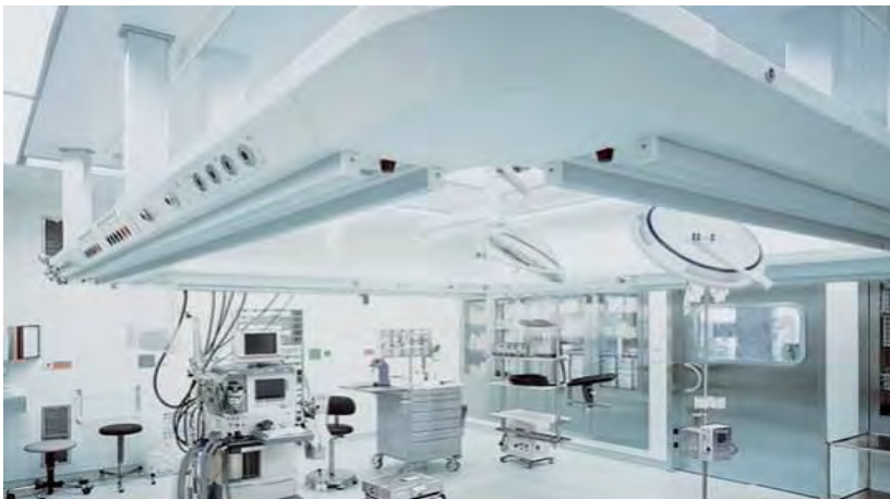
Abb. 29: TAV-Lüftungsdecke mit IS 500 OP-Medienbrücke
