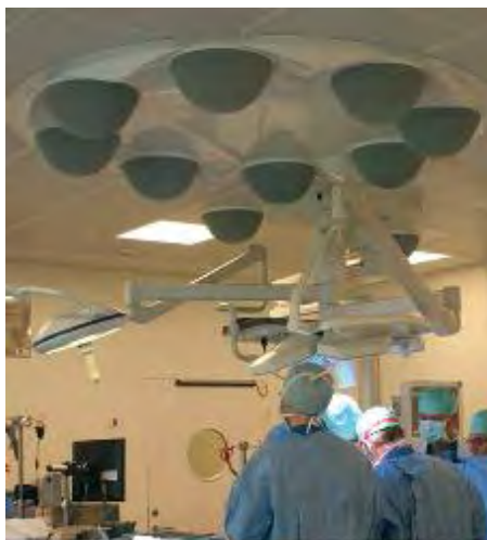
Abb. 31: Temperaturkontrollierter Airflow – TAF-Zuluftauslässe
